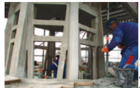
Mise en œuvre du mortier de réparation sur les arêtres de la flèche de l'église de Lamotte-Warfusée (Somme).
